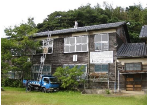
(2013.10.4 自主的屋根雨漏り調査、修理見積)
