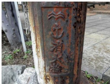
画像⑤消火栓刻印詳細
